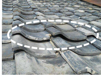
瓦に浮き上がりが生じている
